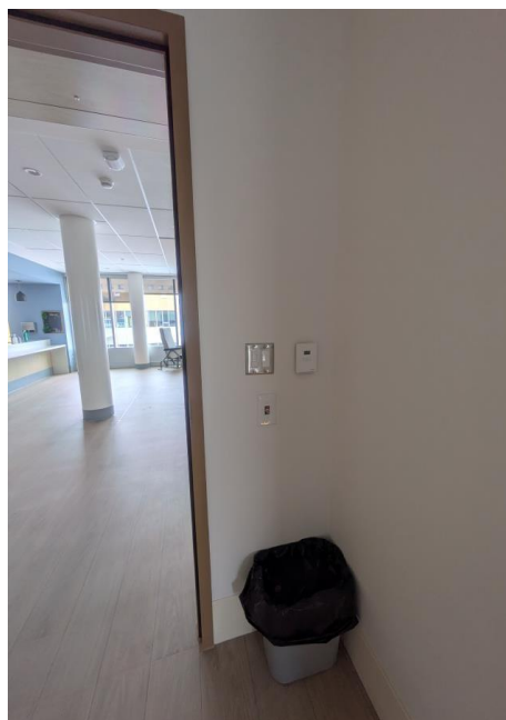
Hauteur adaptée des dispositifs dans les chambres (interrupteurs et thermostat).
