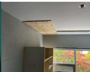
H212 - trou dans le plafond, retouches peinture
