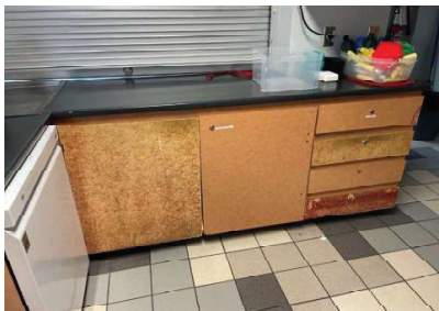
H-227 cuisinette - meubles désuets à remplacer
