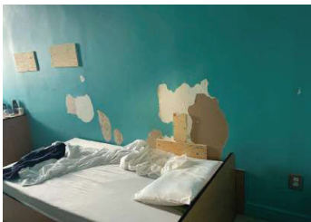
D403 - réparations majeures requises dans le bloc D niveau 400
